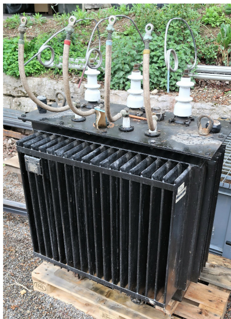
Der alte Trafo – ein Museumsstück – wird später im Stollen platziert.
